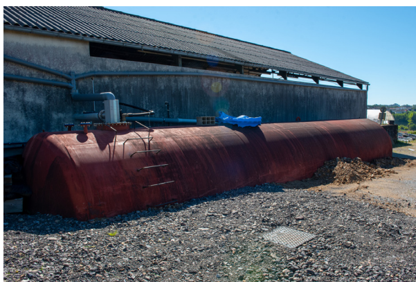
Cuve de récupération d'eau aux serres de la Vergne
